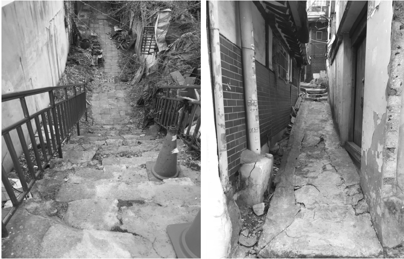
[그림 5-1] 옥인1구역과 사직2구역의 무너진 점도 불량 도로(2018년 3월 촬영)
