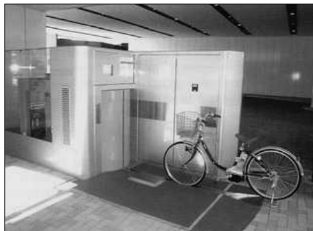
건물 주차장에 설치된 전동 자전거 충전시설
