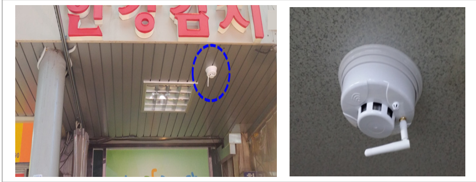
[그림 6-3] 압사시장 내 지능형 화재감지시스템 설치 모습
