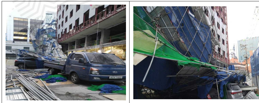
[그림 4-7] 중구 다동 리모델링 공사 사고 현장 사진
