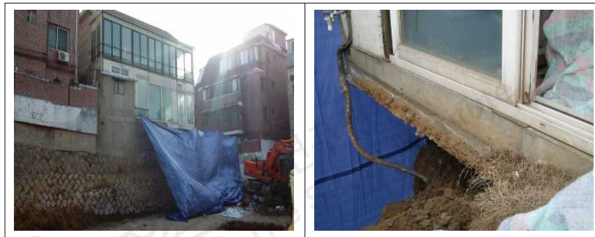
[그림 4-5] 강서구 화곡동 공동주택 신축공사 사고 현장 사진
