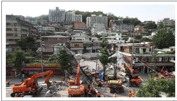
[그림 4-8] 홍은동 3층 리모델링 공사 사고 현장 사진
