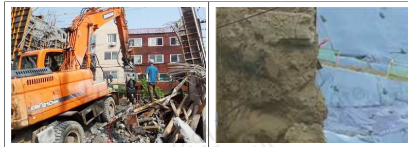
[그림 4-1] 금천구 다세대 신축공사 사고 현장 사진
