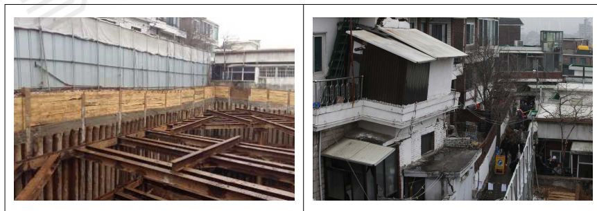
[그림 4-4] 은평구 녹번동 신축빌라 공사장 사고 현장 사진
