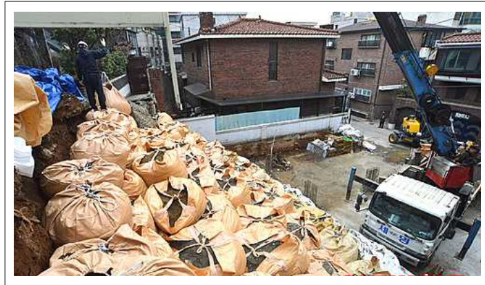
[그림 4-6] 상도동 신축공사 사고 현장 사진
