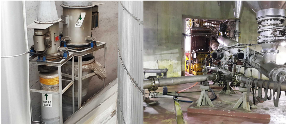
(1) 슬러지 탈수조 포기, 배출구 파손
