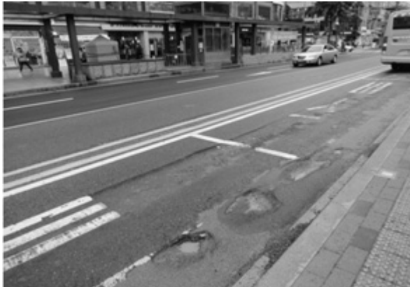
그림 3-20 버스정류장에서의 급가속·급정거로 인한 파손
