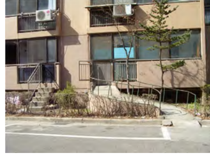
〈그림 3.19〉 임의로 램프 설치한 모습
