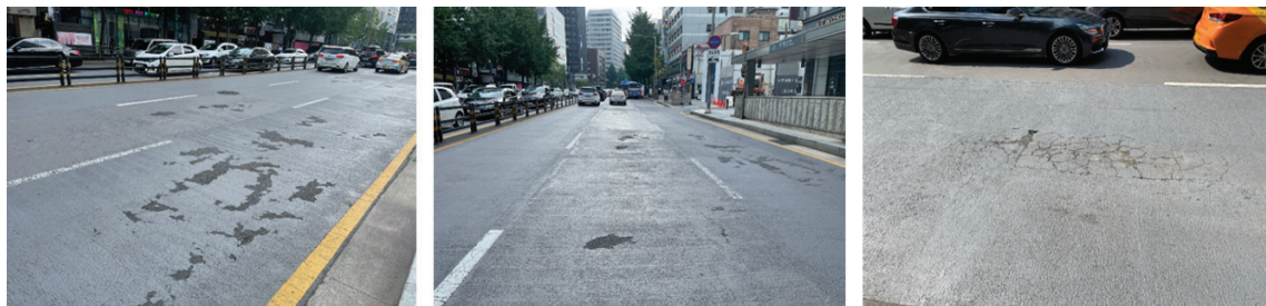
[그림 5] 차열성 포장 파손 사례(서소문로)
