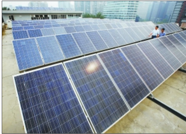
【베이징市 81 중학교 옥상에 설치된 태양열집열판】
