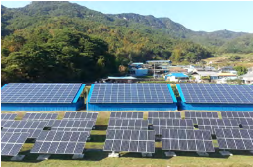
[그림 6-10] 차양형 태양광 발전설비
