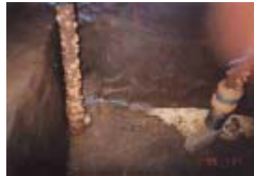
<그림> 콘크리트저수조 내부 배관 부식
