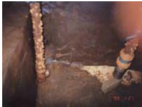
<그림 3-32> 콘크리트저수조 내부 배관 부식
