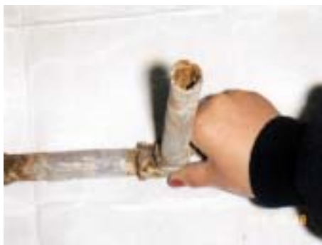
<그림 3-50> 통수년수 22년인 건물의 세대내 급수관 내부 상태
