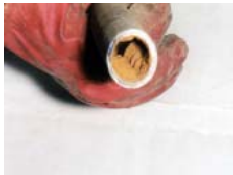
<그림 3-40> 통수년수 11년인 건물의 옥내 급수관 내부 상태
