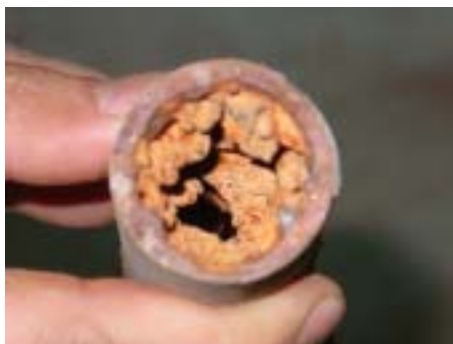
<그림 3-54> 통수년수 25년인 건물의 세대내 급수관 내부 상태
