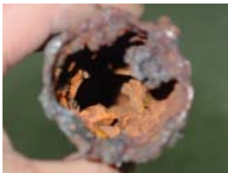
<그림 3-52> 통수년수 25년인 건물의 공동구역 급수관 내부 상태
