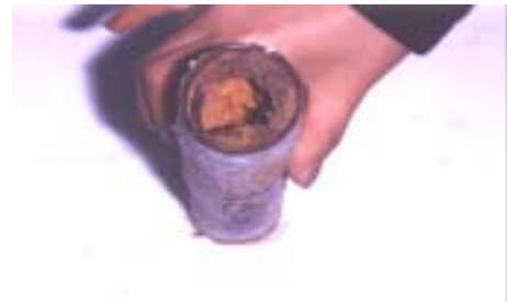
<그림 3-44> 통수년수 13년인 건물의 세대내 급수관 내부 상태
