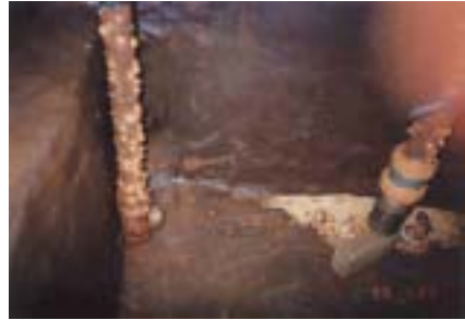
<그림> 콘크리트저수조 내부 배관 부식
