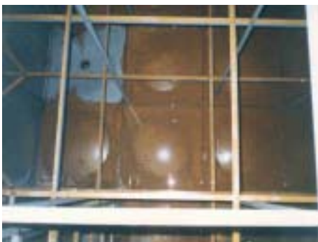
<그림 3-29> 스테인레스저수조 바닥 상태
