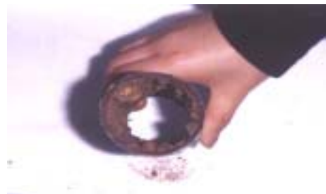
<그림 3-46> 통수년수 13년인 건물의 저수조내 입상관 내부 상태
