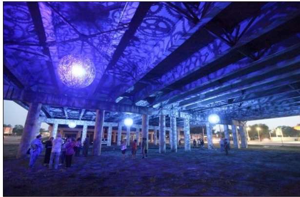
<고가도로 밑에 설치된 LED 조명시설>
