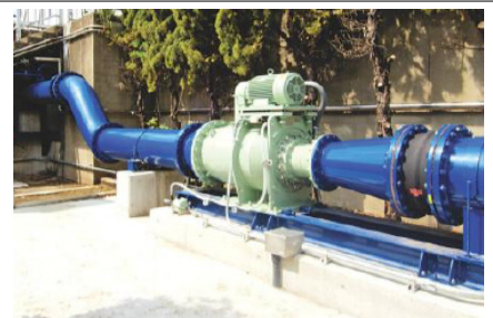
펌프간 낙차를 이용한 소규모 발전
